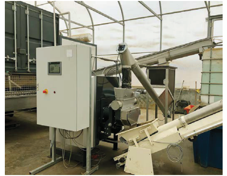
Erwartungen voll erfüllt: Der Anlagenbetrieb läuft problemlos. Bild: Jumbo
